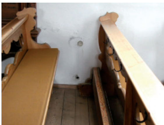
Mittels Kernbohrungen wurde vor der Sanierung eine Analyse des Mauerwerks durchgeführt. Dabei stellte sich heraus, dass die Kirchenmauer zweischalig aufgebaut ist: Zwischen zwei Wänden aus Fluss- und Felsgestein befindet sich ein mit Schotter gefüllter Spalt.
