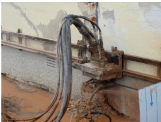
Über eine Führungsschiene wurde die Diamantkettensäge an der Außenwand des Kirchenbaus positioniert. Die Säge schneidet abschnittsweise eine Fuge durch das Gestein, in die anschließend eine Edelstahlplatte eingezogen wird. Auf diese Weise wird die Mauer vollständig abgedichtet, sodass keine kapillare Feuchtigkeit mehr hochsteigen kann.
